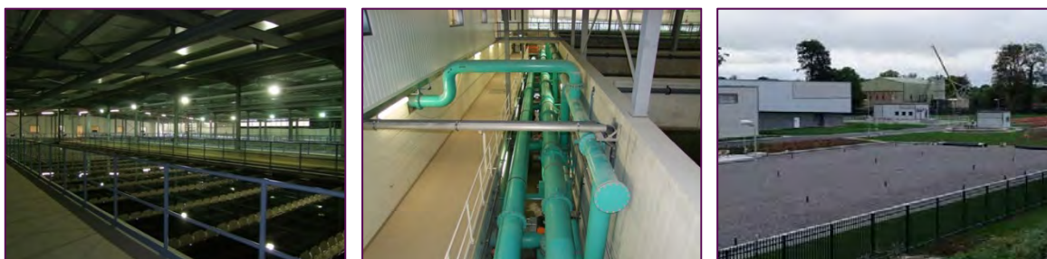
Síneadh le Saoráid Fuíolluisce Léim an Bhradáin.
